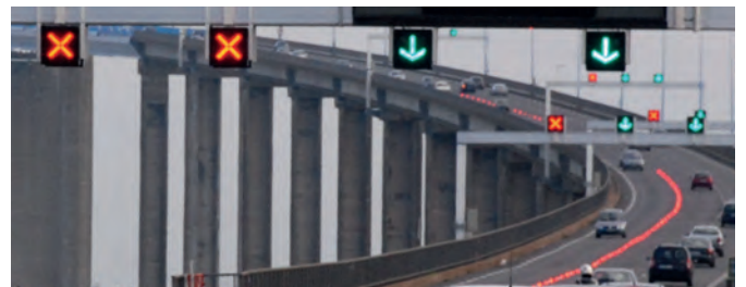
Signalisation dynamique par feux d'affectation de voies
